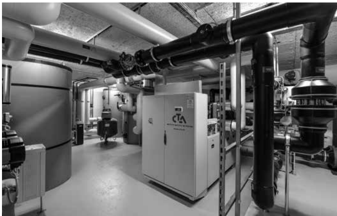
Bild: Zentrale der neuen 250kW Grundwasser-Wärmepumpe.
